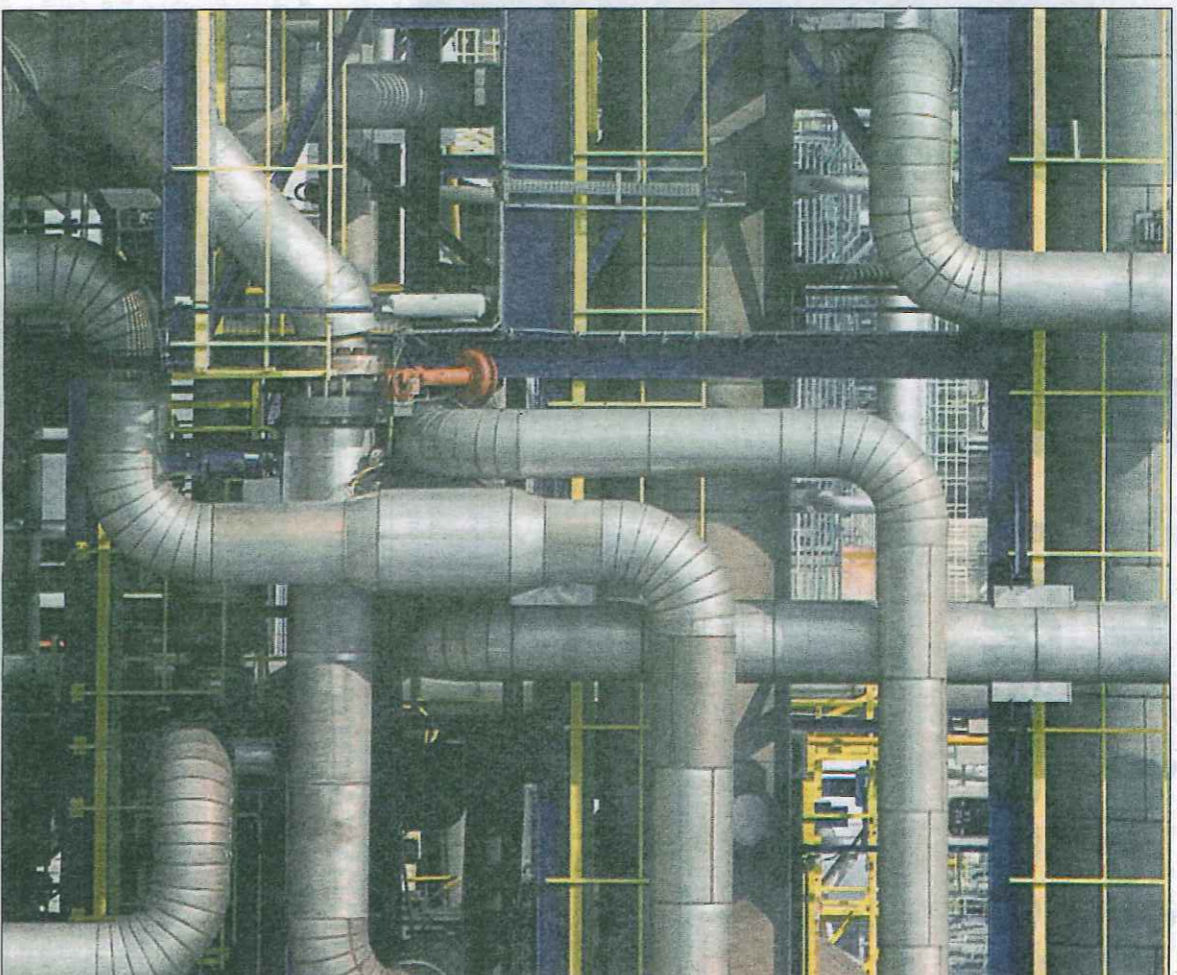
Door de buizen, kleppen en pijpen van BioMCN in Delfzijl stromen straks alleen nog groene grondstoffen.
